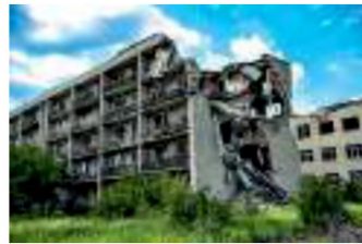
Іл. 44.11. Руїнування будівлі внаслідок обстрілу
